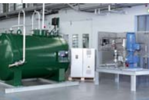
Емкость на 3.000 л с насосами LDB, шкаф управления для установки вне взрывоопасной зоны
