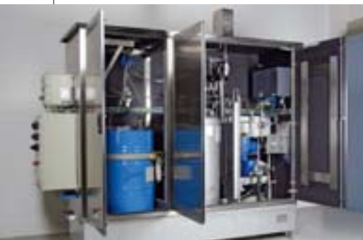
Установка OD 240 в отапливаемом шкафу, трубопроводная арматура для заправки из одноразовых емкостей, шкаф управления во взрывозащищенном исполнении
